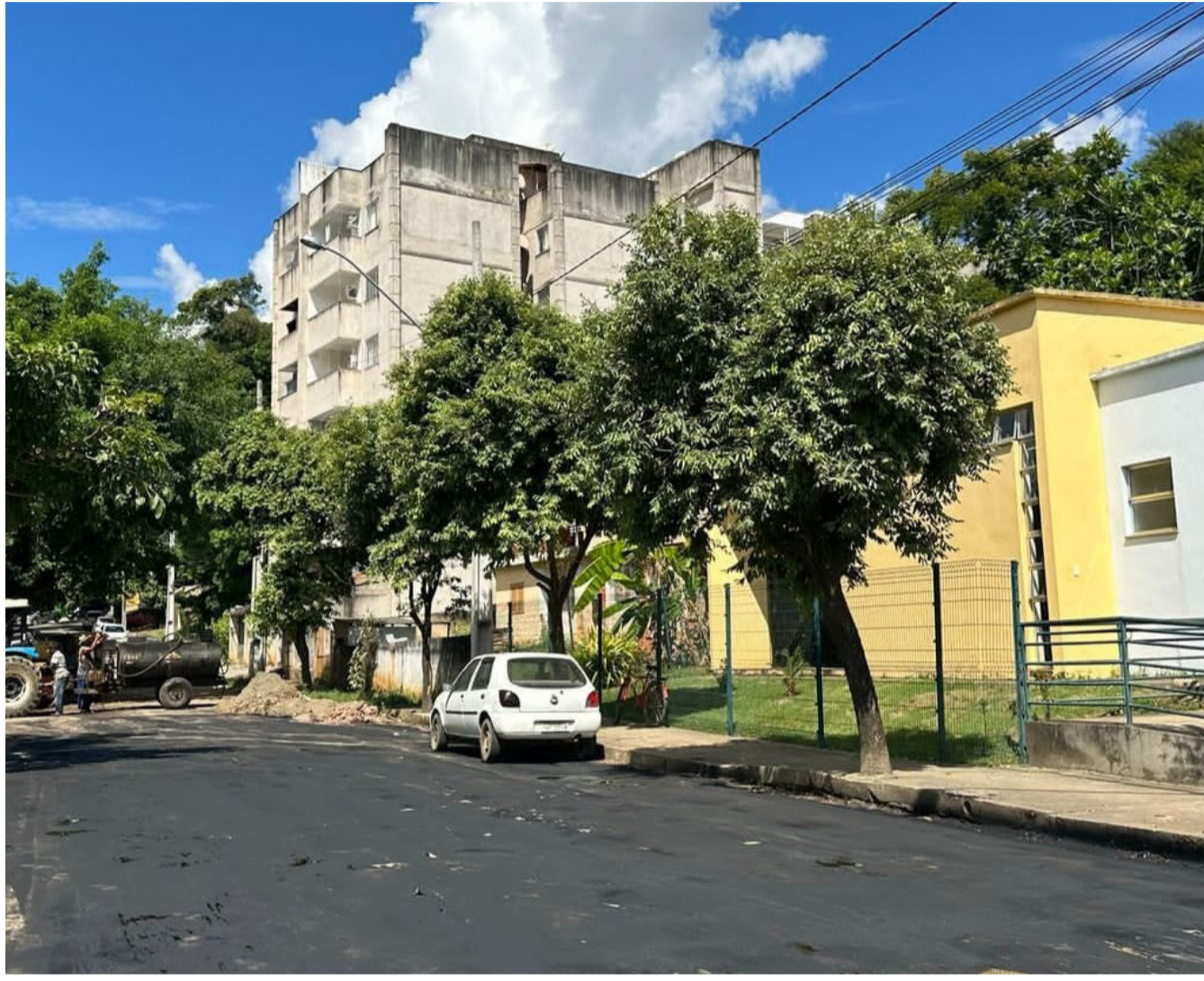
Foram utilizados em frente ao prédio da Policlínica Municipal Dr. José Júber cinco metros cúbicos de asfalto
