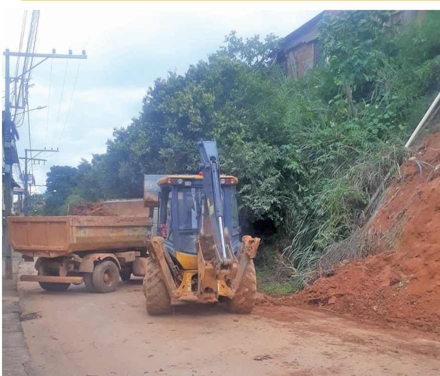
O bairro São Diniz foi o mais atingido pelas quedas de barreiras e lamas. As ruas Paulo Matoso e Joaquim Oliveira Martins foram desobstruídas ainda no início da semana com o uso de máquina retroescavadeira
